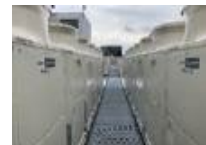
空調設備の更新 (Daiwa銀座ビル)
